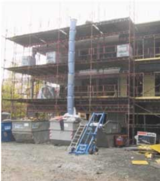
Ja būvdarbus veicot ievēro koncepcijas "Tirais būvlaukums" pamatprincipus, būve radīs pozitīvas emocijas, gan celtniekiem darbu laikā, gan gatavās ēkas lietotājiem pēc darbu pabeigšanas.
